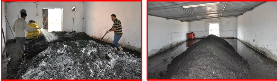
Örtü toprağı hazırlama ünitesi ve toprak hazırlığı
