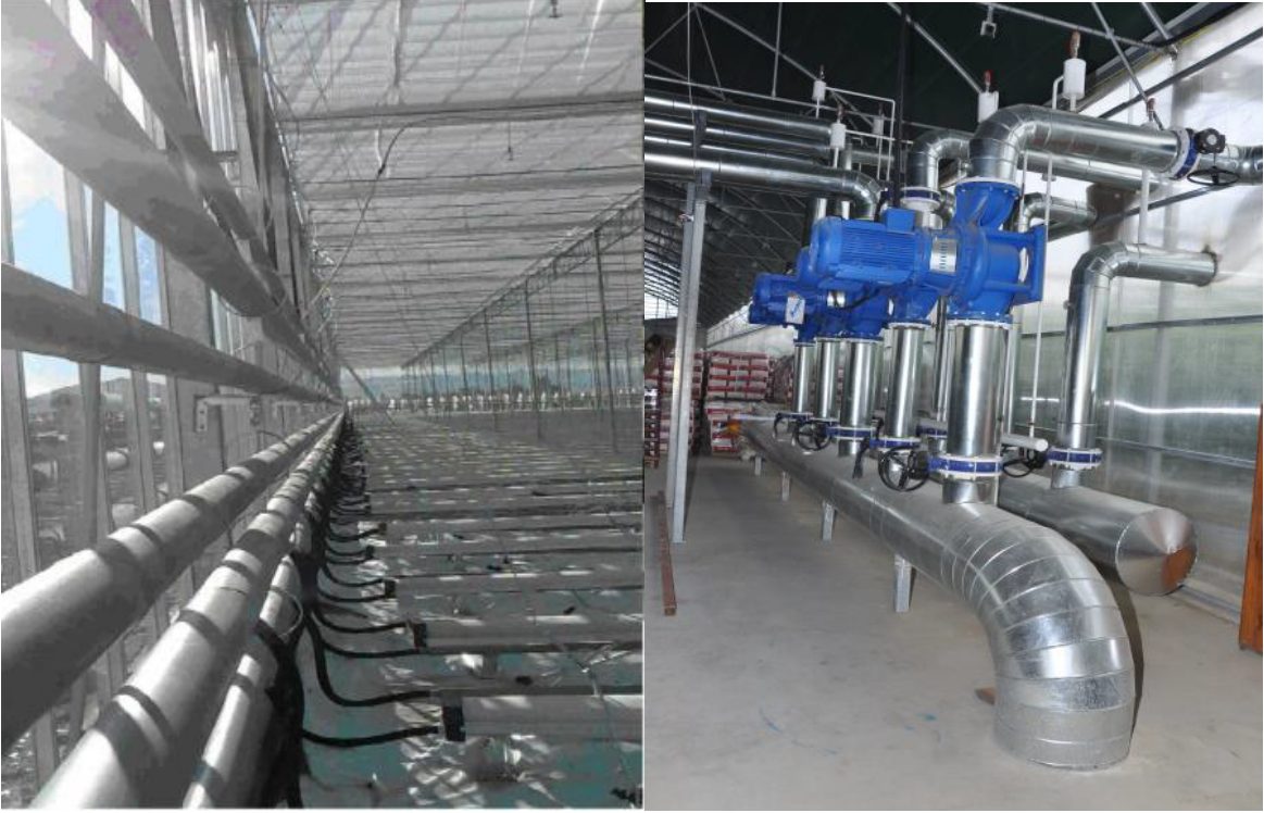
Isıtma sistemi ve ısı odası görünümü
